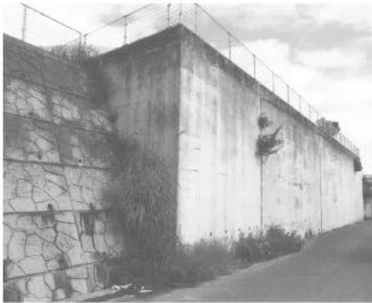
▶保育園の南側の擁壁7m水抜き穴は下方だけ(現場仕上げ)
