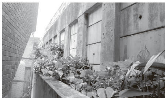
▶TY自動車整備工場裏手の擁壁
