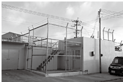
改修することになった屋宜原団地の浄化設備
