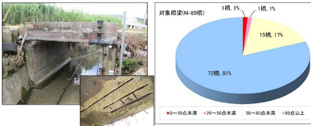
図-3 損傷事例（頂版の剥離・鉄筋露出） 図-4 橋梁の健全度の割合（平成 24 年度現在）
