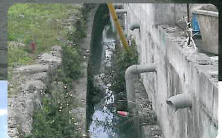
下水道へ接続していない多くの家庭の台所からの排水や洗濯水等がそのまま川にながれています
