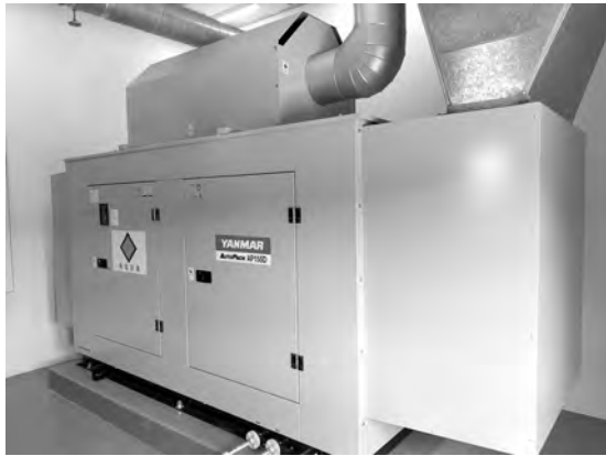
庁舎の非常用発電設備（発電機）
