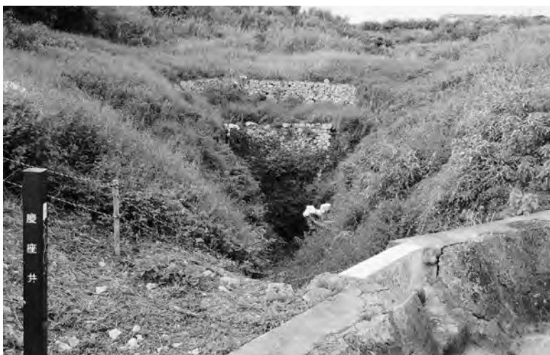
石積みの崩壊、土砂の流失が進む町指定文化財「ギーザ井」
