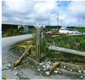
字東風平での電柱倒壊
